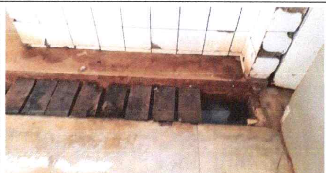
Foto 04: Tampa da canaleta inadequada e acúmulo de água servida
