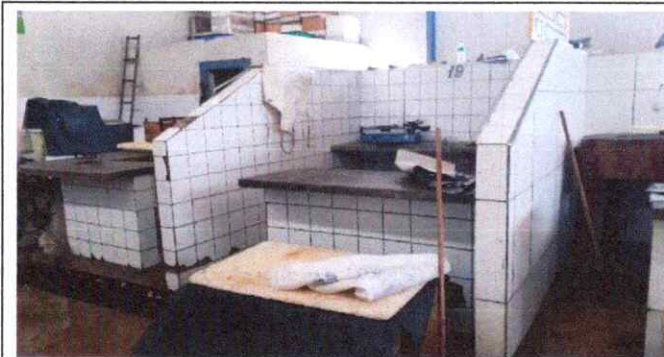
Foto 03: Revestimento e bancada deteriorados
