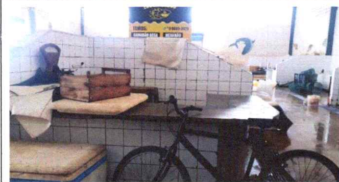
Foto 01: Revestimento e bancada deteriorados
