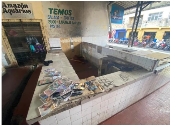
Foto 01: Revestimento e bancada deteriorados
