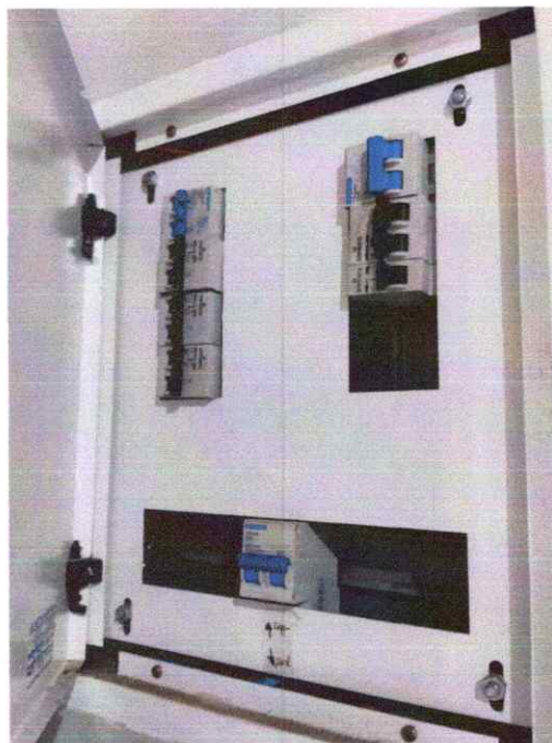
Imagem 03: Quadro de distribuição.
